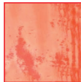
Materialangriff der natur/ farbeloxierten Aluminiumoberfläche bei Containern. Ursache: unzulässig hohe alkalische Waschlösung
