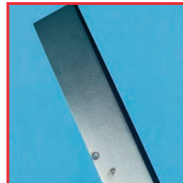
Beispiel für Lochkorrosion
